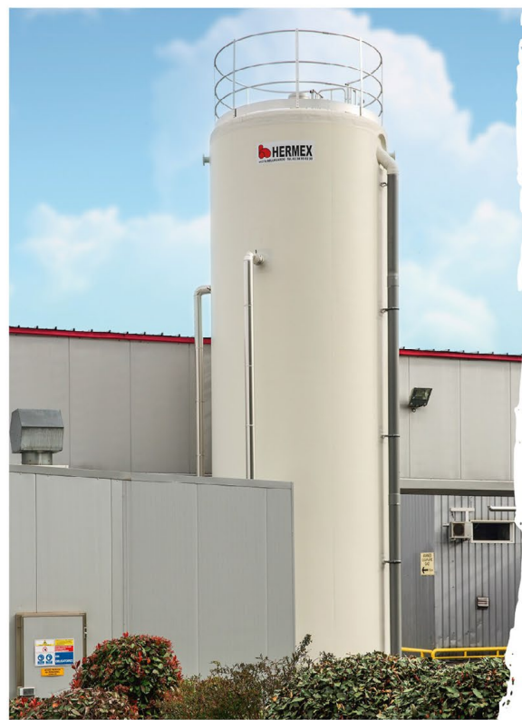
Tour de récupération de chaleur
