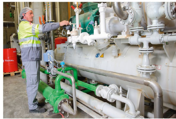
Système de récupération de chaleur
